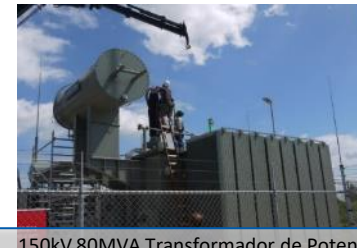
150kV 80MVA Transformador de Potencia Estonia
