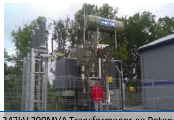
347kV 200MVA Transformador de Potencia Estonia
