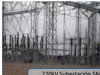
220kV Subestación SMCO Congo
