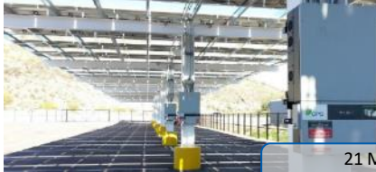
21 MW Tucson, USA
